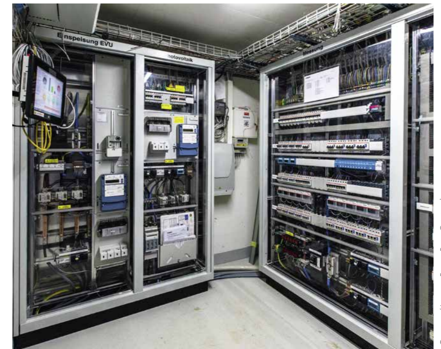
So sieht intelligente CO 2 -Spar-Hightech auf der Hardwareseite aus: Blick in den Elektronikraum im Tiefgeschoss des Hauses.
